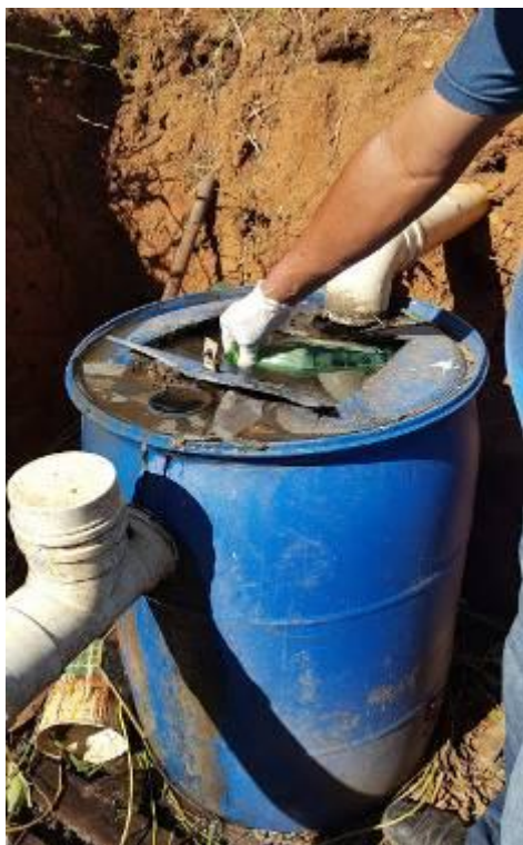
Figura 2: Tanque de equalização de vazões.
